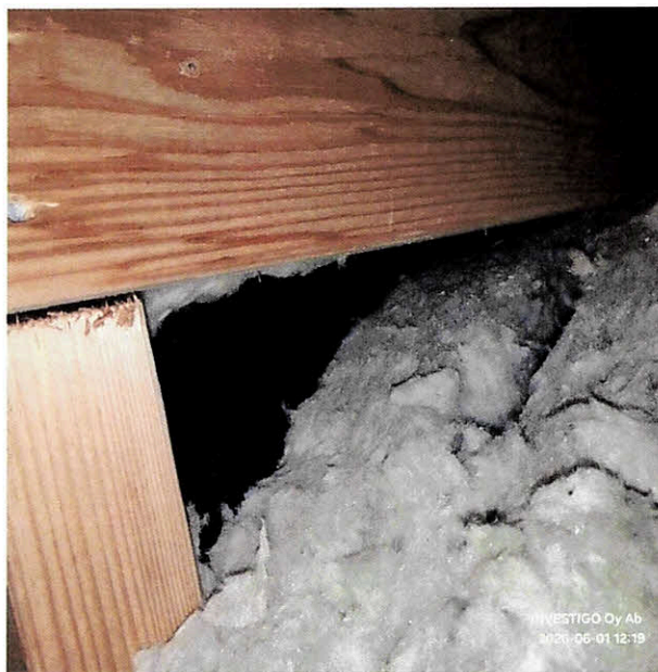
33. Ytterväggar har luftspärr av bitumenpapp och inte plast, åtminstone vad som kunde ses från övre våningens vägg under värmisoleringsen.
