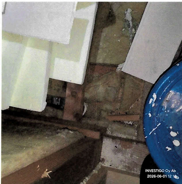
8. Musspillning i isoleringen på mellantak mot norr.
