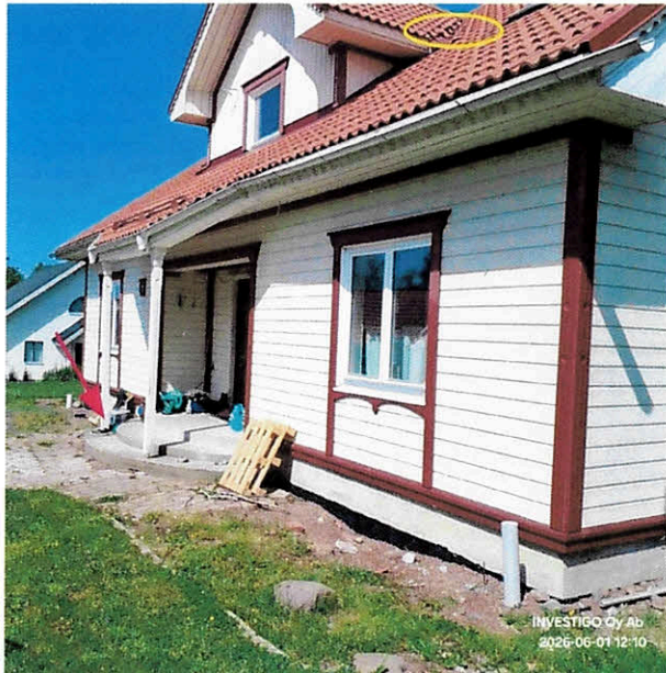
6. Framsida på huset. Girrännornas takpannor söndriga. Den ena pelaren som håller upp dörrtaket lös.
