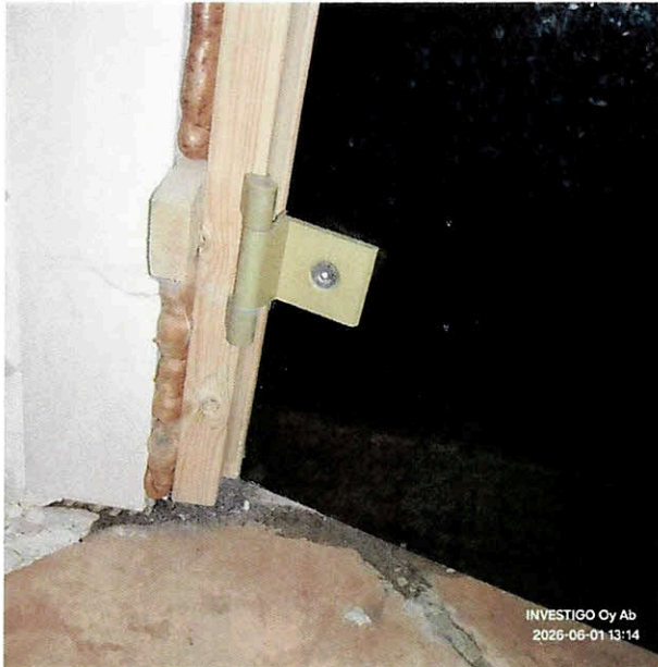
62. Detaljre och ytmaterial kring bastudörr saknas.
