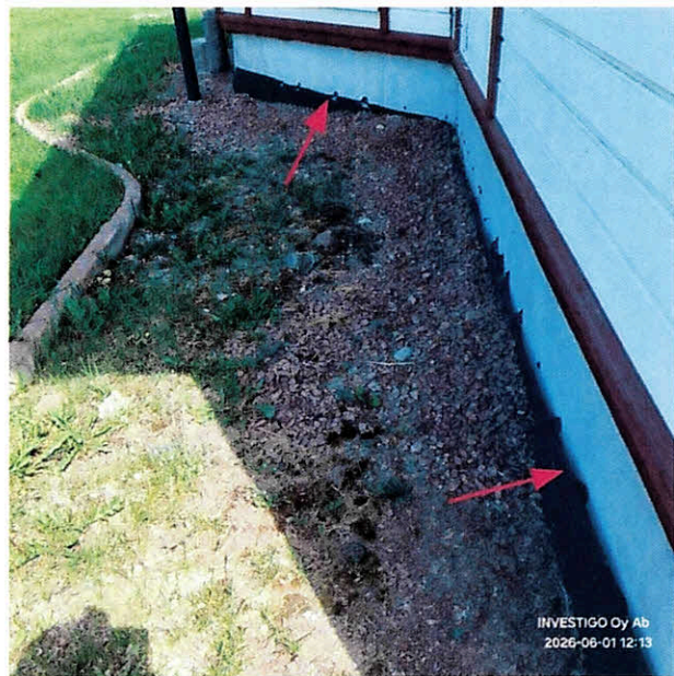
25. Luftspaltsbildande sockelmatta bristfälligt monterad och monteringslist i övre kant saknas. Mattan släpper ställvis från sockeln.
