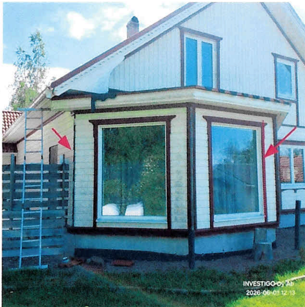
34. Knutbräden saknas på burspråket. Båda sidor vid anslutning mot huskroppen.
