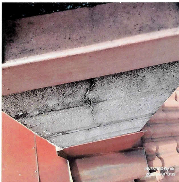
46. Spricka utsida skorsten.
