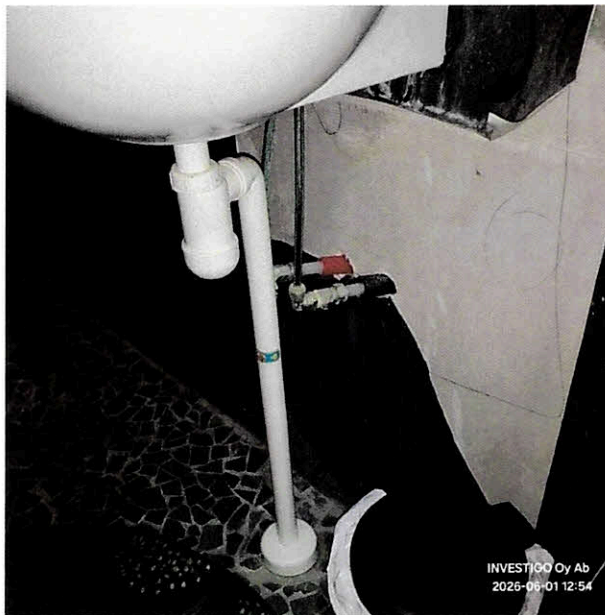
72. Tapet saknas delvis under tvättställ.
