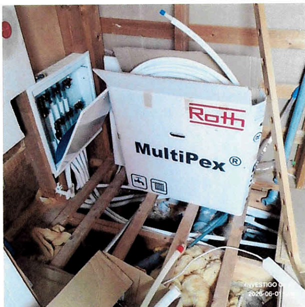
54. Rörfördelarskåp finns i övre badrum. Avloppsrör öppna men ingen avloppslukt kändes. Oklart om de är anslutna till avloppssystemet.
