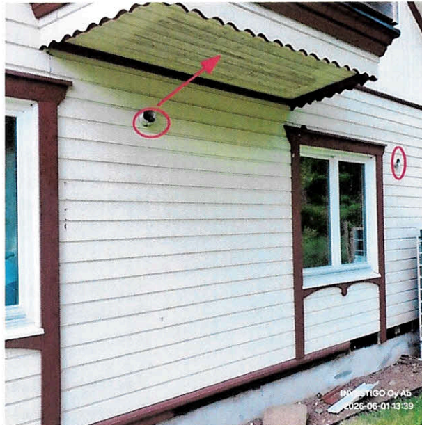
31. Ventilationsgenomföringar i fasad bristfälliga här på östra sidan men även vid kök på västra sidan. Notera även att undersida vindsbalkong mot öst tar skada av fukt som ventileras ut.
