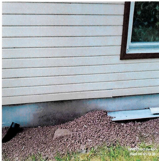
27. På östra sidan ses ej sockelmattan. Missfärgad sockel. Hängränna ej fullständig ovanför vilket troligen är orsak, regnvatten skvätter på sockel istället för att ledas ner till rör i mark.
