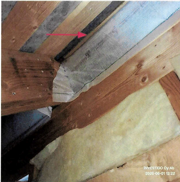
14. Luftspalten ovanför lutande innertak på vindsvåning smal. Svårt att säga om den klarar av att ventileras ända tillnockvinden.
