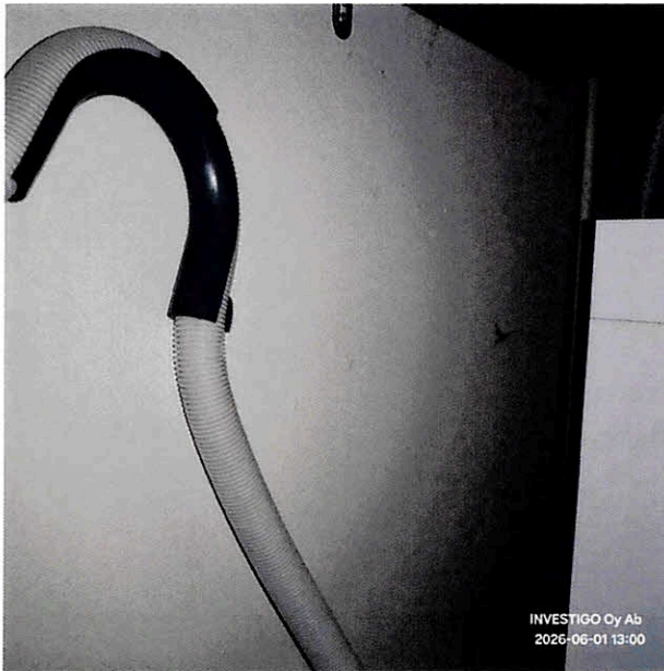
85. Man har på korrekt sätt fäst avloppsslang under bänkskiva med bygel.
