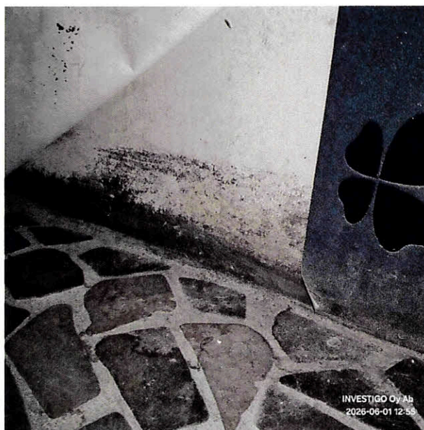
76. När en öppnade på tapeten där den var lös, vägg mot klädvårdsrum, noterades några silverfiskar. Det svarta troligen fogmassa från golv och inte mögel. Utrymmet har inget uppvikt tätskikt från golv.
