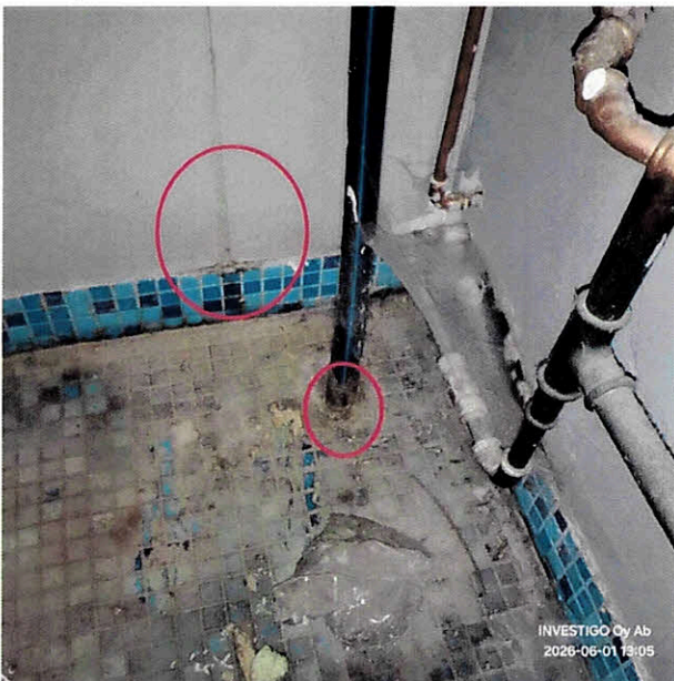
88. Tätskiktsgenomföring bristfällig vid vattenledning som kommer upp genom golv, plastslang. Rinnmärken av fukt på vägg.
