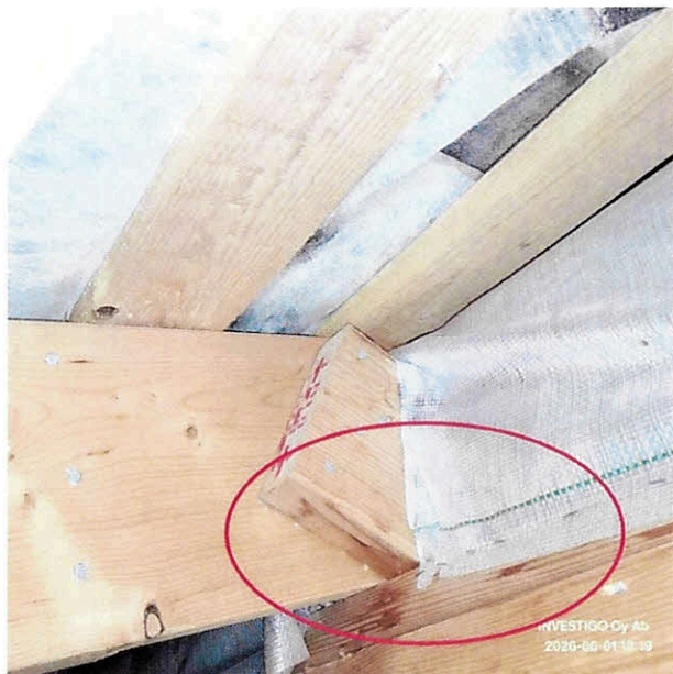
10. Fuktmärken på träreglar i mellantakets anslutning mellan norra delen och vindsdelen. Såg svaga ut och kan härstamma från byggskedet. Bör hållas under uppsikt oavsett.
