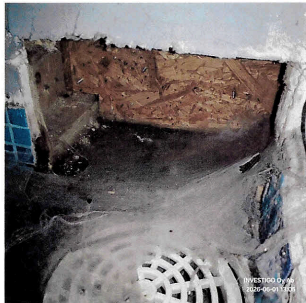
89. Tätskikt om sådant ens finns, brutet vid golvbrunn så mellanväggen börjat ta skada. Oklart av vilken orsak det finns en öppning in till mellanvägg här.
