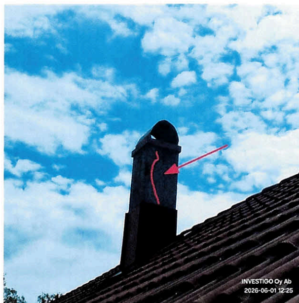
44. Skorsten sprucken på utsidan, ses på både östra och västra sidan. Inuti pipan noterades inga sprickor på denna nivå. Sotare bör gå igenom eldstäder innan de tas i bruk. Man bör även kontrollera att brandskyddsmyndigheten gjort godkänd syn.
