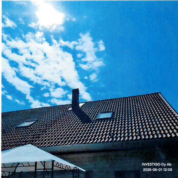
2. Inga avvikelser förutom söndriga pannor vid girrännor observerades på de stora takytorna i sin helhet. Inomhus kunde jag inte se några tecken på läckage ännu.
