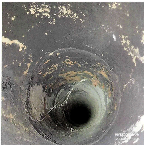
45. Synade skorsten från tak: ingen synlig spricka i pipan så långt ögat nådde här men utsidan sprucken ovan tak.
