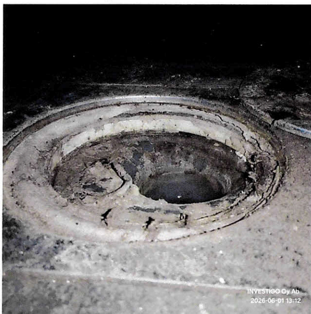
66. Här finns klämring som inte finns i badrummet intills golvbrunn.
