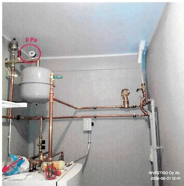
40. Ärgning på rör indikerar läckage. Systemtryck i radiatorkrets 0 (samma notering som föreg. bild).
