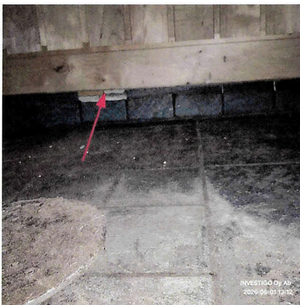
67. Ångspärr på vägg ej tätt ansluten till golvet tätskikt. Kan betraktas i uppviket under bastupanelen.
