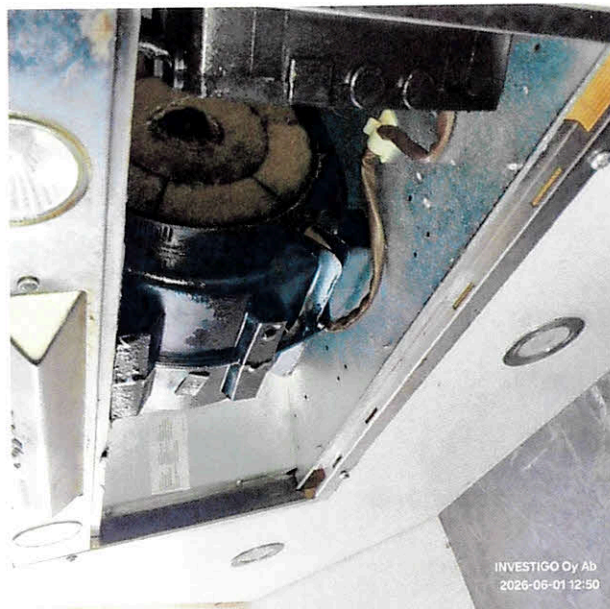
52. Fettfilter saknas före köksfläkt och fläkten igensatt av smuts. Bör rengöras för att inte utgöra brandfara.
